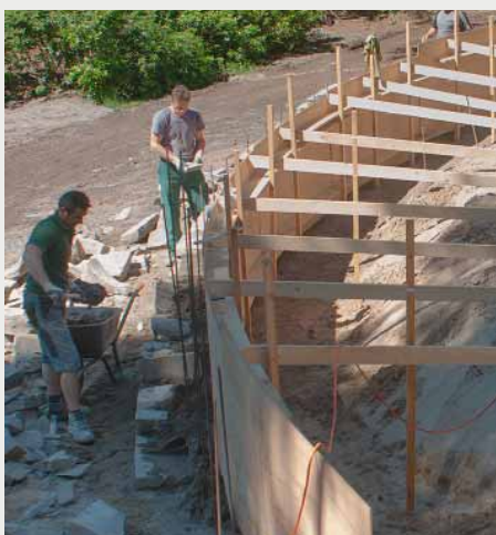
Natursteinmauer-Rondell: Vor dem Mauern der Bruchsteine wurde eine Holzverschalung gebaut. | Foto: Verena Sprung
